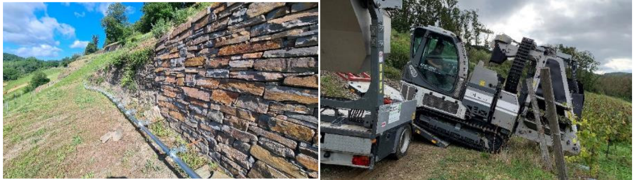
Abb. 4: Neue Weinbergsmauer mit Sicherungsschiene (l.) und Einsatz des RMS vom Anhänger (r.)
